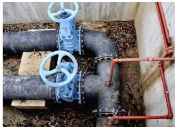
Figura 7. Puntos de inyección de coagulante en tubería de agua bruta (Díaz, 2021).
