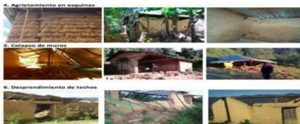
Figura 5: Fotografías del diagnóstico de daños en las viviendas de adobe.
