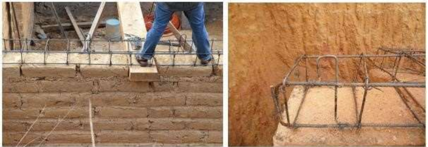
Figura 6: Armado con grapas de acero amarradas a cada 60 cm para anclar la estructura de madera a los muros.
