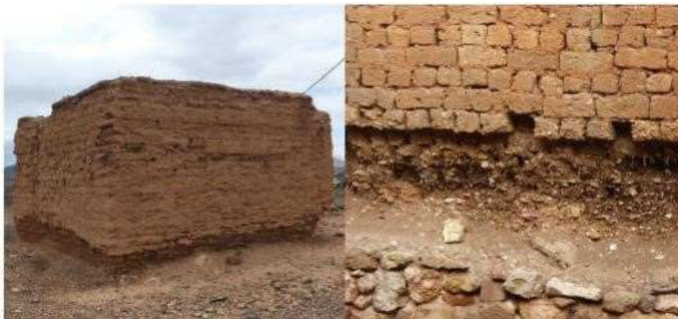
Figura 2: Desgaste de adobe en la base de muros.
