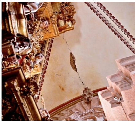
FIGURA 8. Grieta en Cúpula de 40 cm.
